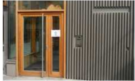
intégration architecturale exemplaire du digicode et d'un transformateur en façade sur rue
